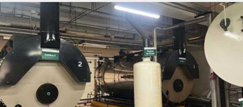
144 Equipos de casa de máquinas $1,109 mdp
